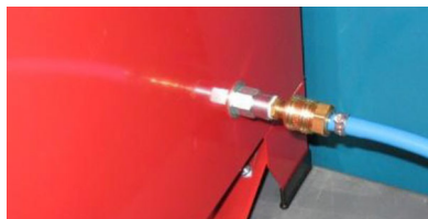
Abb. 10: Anschluss Druckluftleitung SSK1
